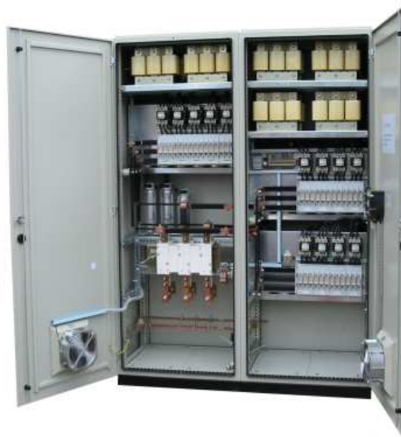
Foto 1. Automatycznie regulowana bateria niskich napięć KMD720R 400V z dławikami (filtry odstrojone) f_r = 189\text{Hz} . Produkcja firmy ELMA energia. Eksport do Holandii.
