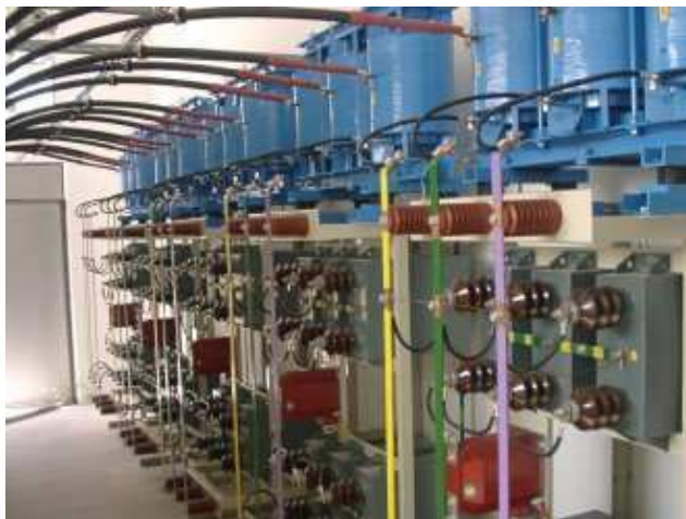
Foto 2. Filtry odstrojone średnich napięć 6,3kV ( f_r = 189\text{Hz} ). Realizacja firmy ELMA energia w Hucie Głogów S.A.
