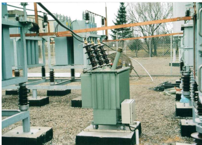
Foto 7. Transformator 63kVA/30kV do szybkiego rozładowania baterii głównej filtra C 2-giej harmonicznej w Hucie Celsa. Moc baterii 33MVar/38,48kV. Realizacja ELMA energia
