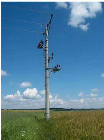
Foto 4. Napowietrzna, nasłupowa bateria kondensatorów 15kV. Produkcja ELMA energia
