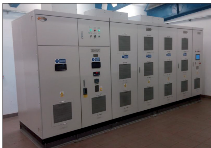
Fot. 2. Kompensator SVG o mocy 6,5 Mvar/6,3 kV. Kompleksowa realizacja firmy ELMA energia Sp. z o.o.
