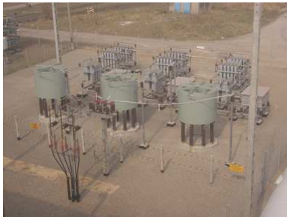
Fot. 5. Bateria kondensatorów 46MVar/38,5kV w Hucie „CELSA” Ostrowiec Św. Realizacja ELMA energia
