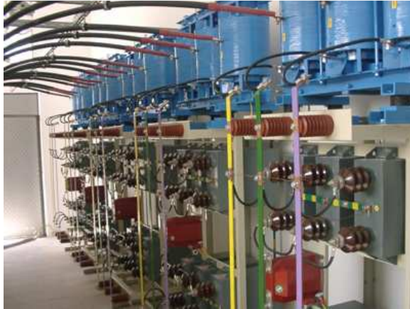
Fot. 11. Odstrojony filtr 5-tej harmonicznej 6,3kV. Realizacja „ELMA energia” w Hucie Miedzi Głogów
