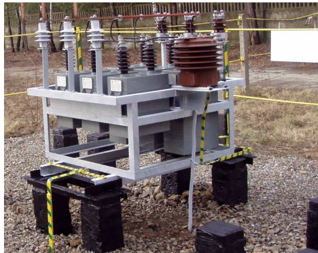
Fot. 3. Bateria kondensatorów 1,2MVar/6,3kV w układzie podwójnej gwiazdy z zabezpieczeniem zero-prądowym od zwarć wewnętrznych w ZGH Bolesław. Realizacja ELMA energia
