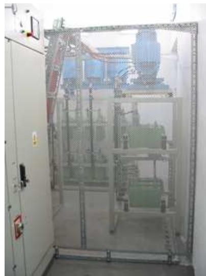
Fot. 10. Automatycznie regulowane baterie kondensatorów ACR 6,3kV w KWK Bogdanka. Realizacja „ELMA energia”
