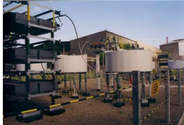
Fot. 12. Filtr pasywny 3-tej harmonicznej 30kV. Realizacja „ELMA energia” w Hucie „Celsa” Ostrowiec Św.
