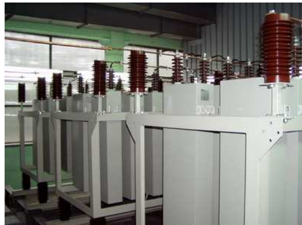
Fot. 6. Wnętrzowa instalacja 35MVar/42kV w Hucie CMC Zawiercie. Realizacja ELMA energia
